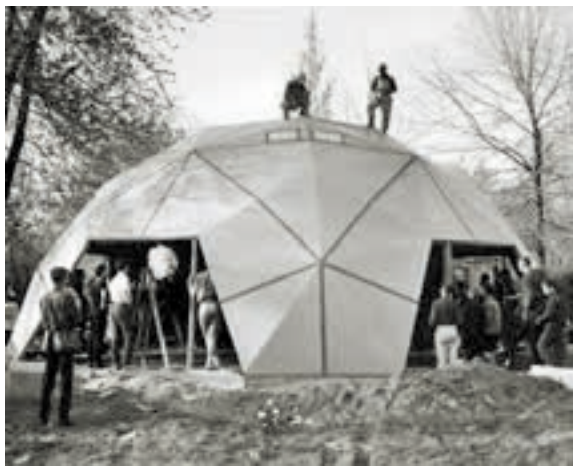
Fig. 6. Casa Fuller en Carbondale durante su construcción, 1960. La cúpula ya se encuentra terminada. Fuente: RBF Dome NFP. Fuller House in Carbondale. In construction, 1960. The dome is now completed. Source: RBF Dome NFP.
